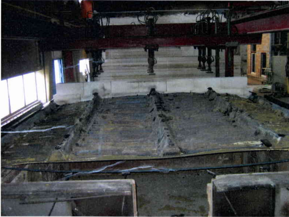
Bild 15: Ansicht des Probekörpers nach Abnahme der Außenschale und der Beseitigung der Steinwolle
